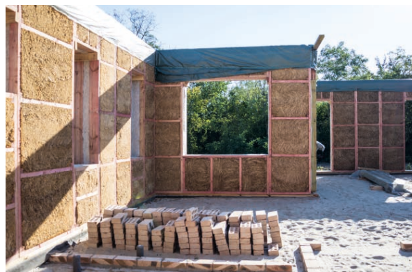
Bau eines Hauses aus umweltfreundlichen, pflanzlichen Materialien: Der Rahmen besteht aus Holz und ist gefüllt mit Strohblöcken. Bild: Shutterstock
